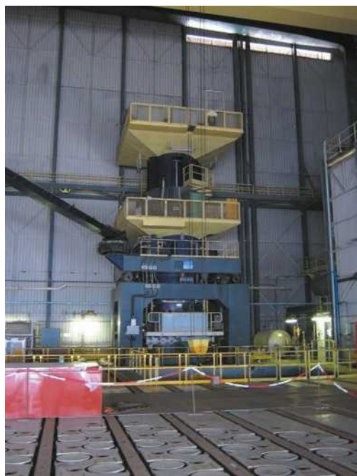
Planche 4 : Réacteur Uranium Naturel Graphite Gaz (première filière française). La plateforme de chargement de Saint Laurent-A et le Dispositif Principal de Manutention. On visualise les rails de déplacement de la machine de chargement et les tulipes obturées à côté d'un canal de CO 2 (photo : Bouchacourt-Foissote-Valdenaire-ENSIB).
