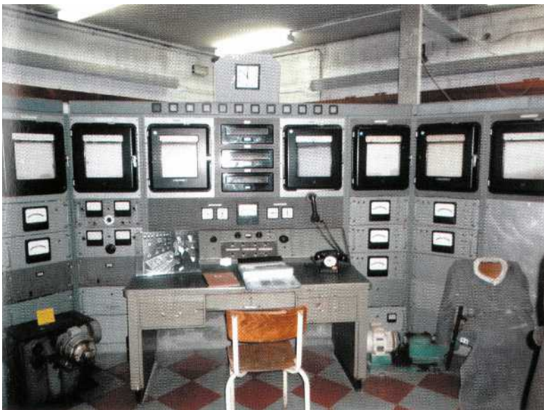
Planche 11 : La même salle de commande de Zoé (France) rénovée à la fin des années 60. De nombreuses tables traçantes « tête haute » ont été installées. On voit les progrès « Facteurs Humains » apportés au pupitre de commande. Le cœur de ZOE s'arrêta de battre le 6 avril 1976 à 11 h 51 après 28 ans de bons et loyaux services, et surtout sans accident ! (photo CEA)
